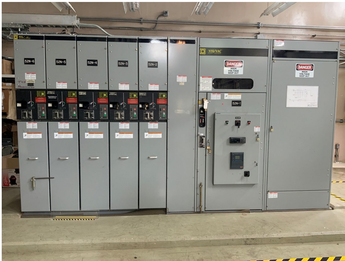
Figura #7. Switchgear real en su instalación actual
