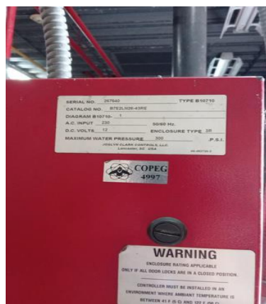
CONTROLADOR BOMBA PRINCIPAL PARA EL MOTOR DIESEL
